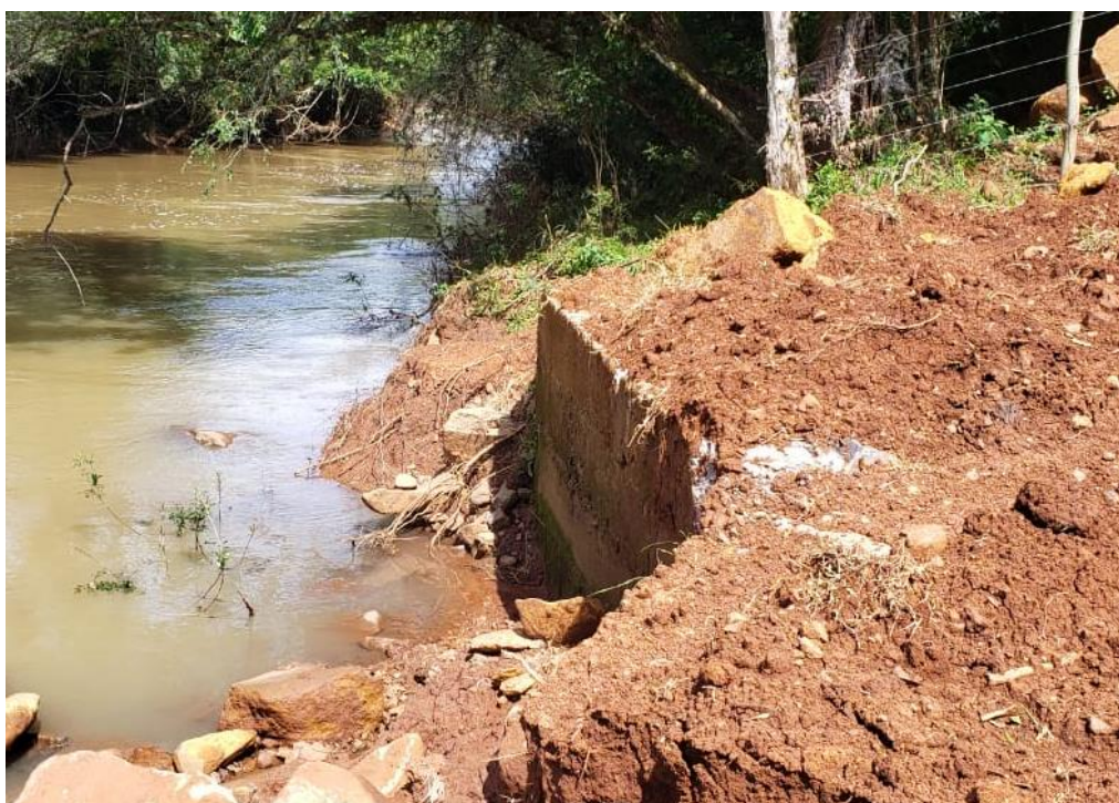
Figura 03: Cabeceira atual que será removida – Lado Monte Carlo - SC
