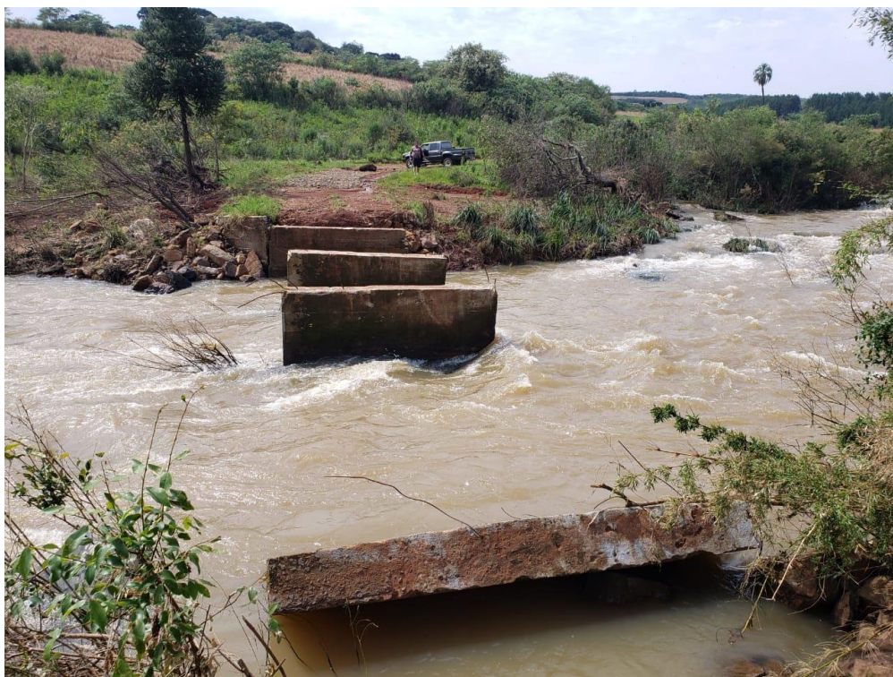
Figura 03: Cabeceira e pilares comprometidos que serão removidos– Lado Monte Carlo - SC
