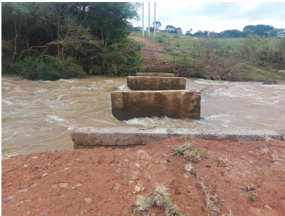
Figura 02: Cabeceira e pilares que serão removidos se necessário – Lado Brunópolis - SC
