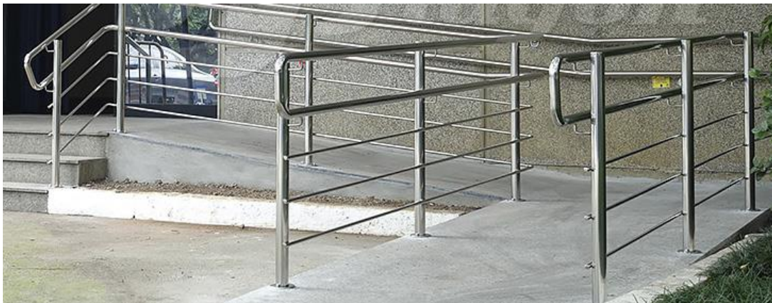
Corrimão Duplo em Aço Galvanizado – Rampa Interna e Externa
