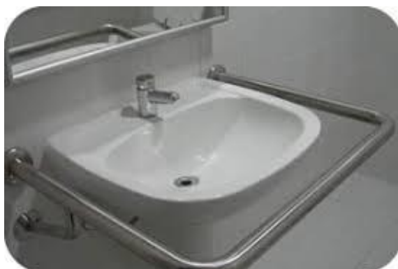
Lavatório com Barra de Apoio
